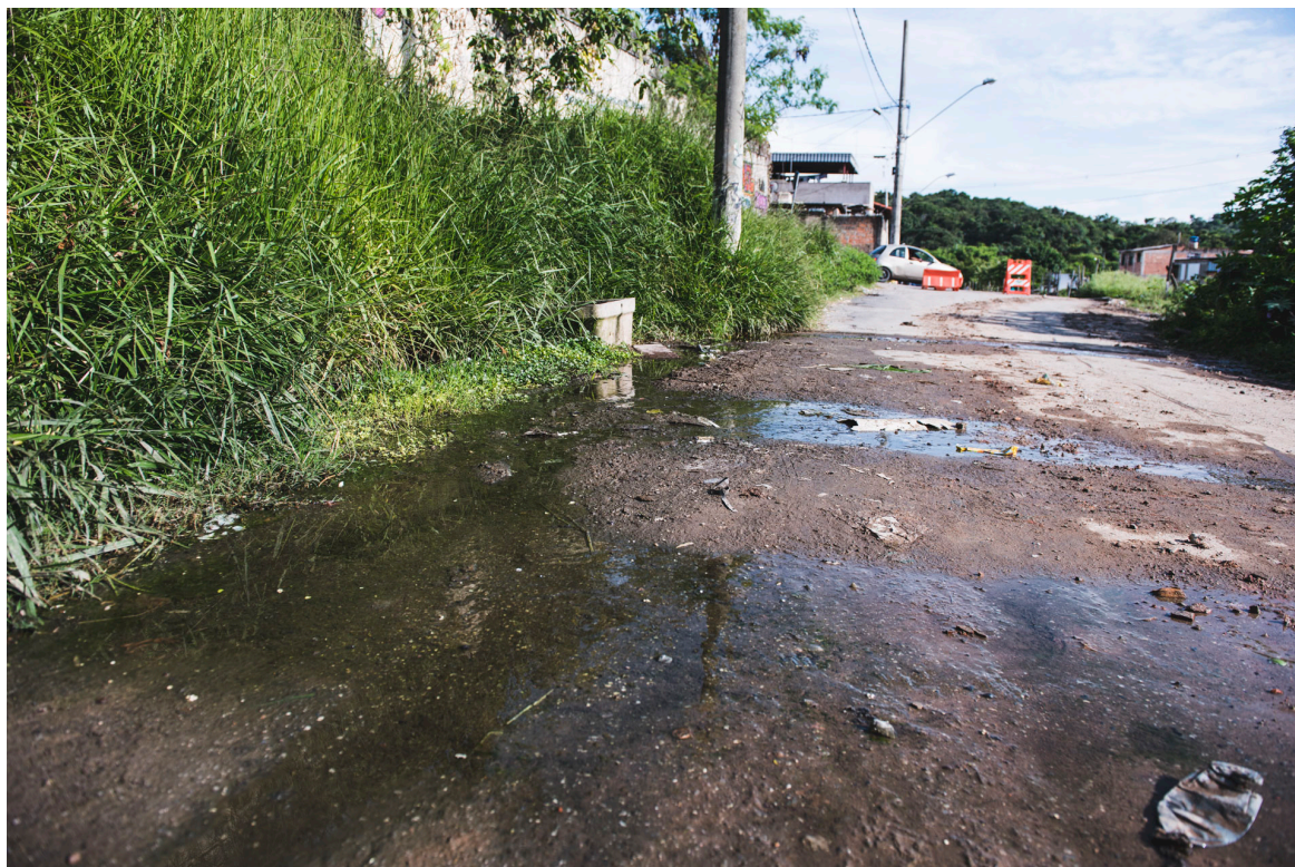
Figura 61 – Antes: construção de via de escoamento de água da bica menor na Nascente da Felicidade - Fonte: Gos Florestal
