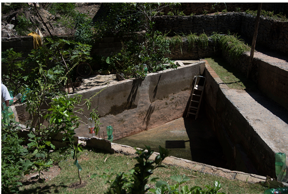
Figura 49 - Estado da Nascente do Agnaldo após limpeza e retirada de entulho, poda e plantio de mudas e grama - Fonte: Gos Florestal
