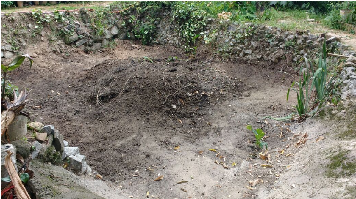
Figura 16 – Limpeza de poço na propriedade na nascente do Alyrio Fonte: Gos Florestal
