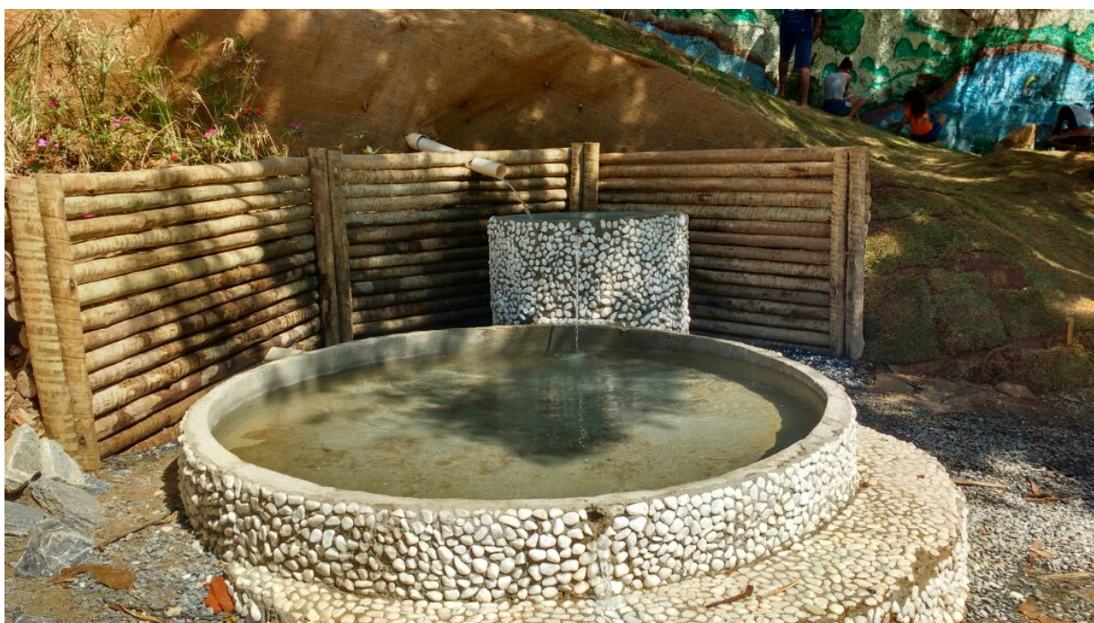
Figura 56 – Depois da obra na bica principal na Nascente da Felicidade - Fonte: Gos Florestal
