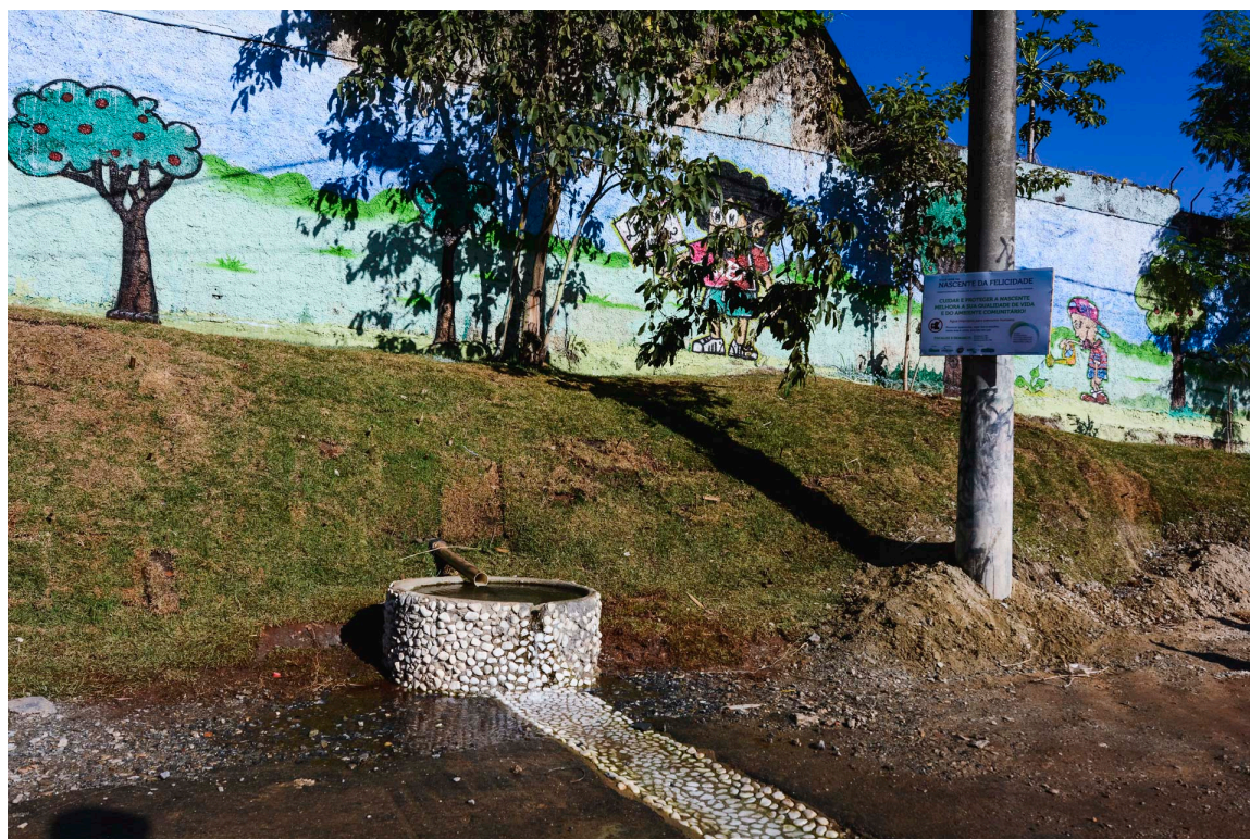
Figura 62 – Depois: construção de via de escoamento de água da bica menor na Nascente da Felicidade, com grafite e placa ao fundo - Fonte: Gos Florestal
