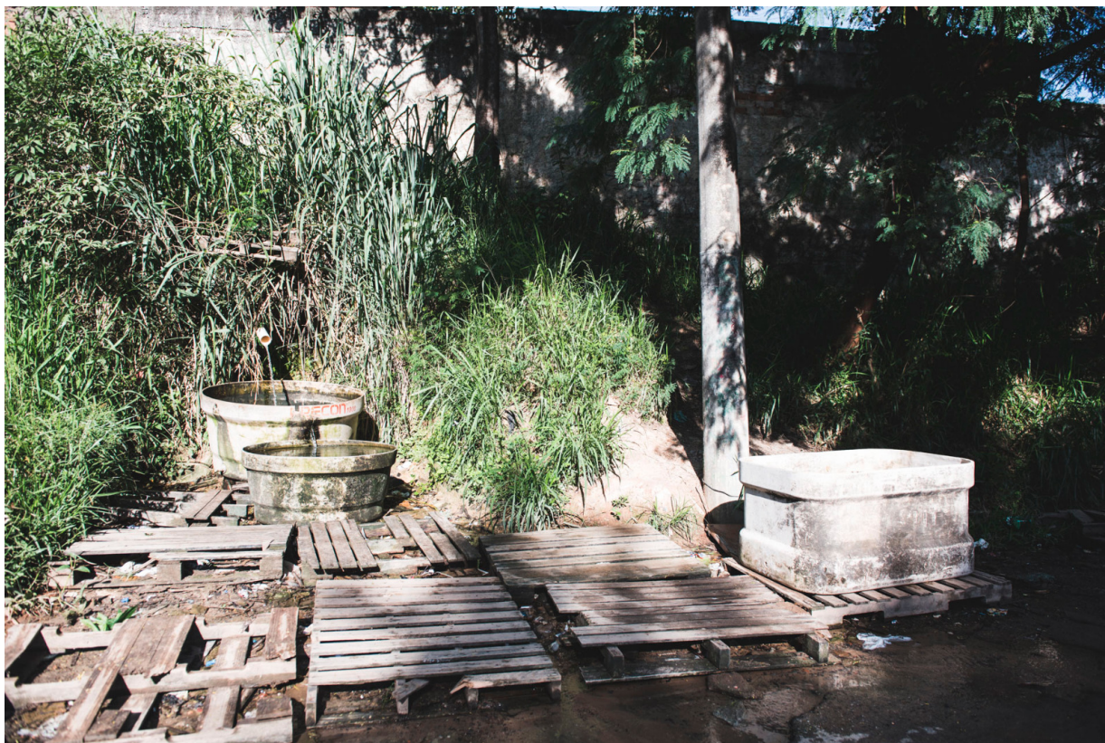
Figura 55 – Antes da obra na bica principal na Nascente da Felicidade - Fonte: Gos Florestal
