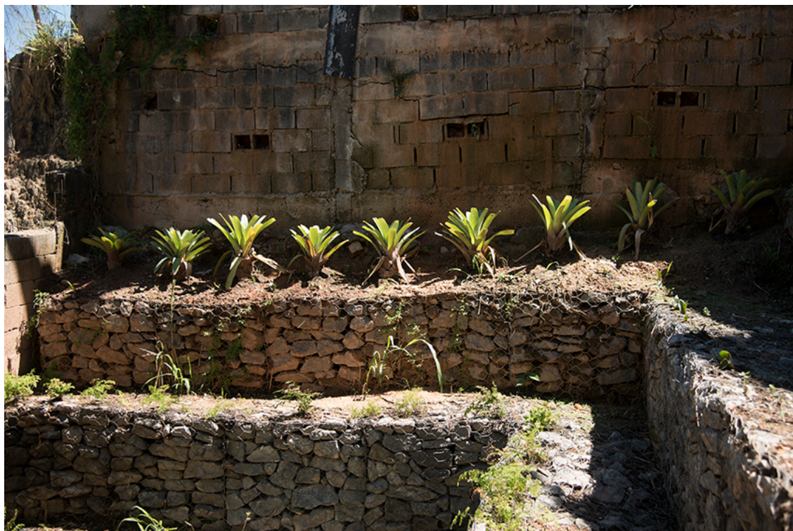
Figura 48 - Estado da Nascente do Agnaldo após limpeza e retirada de entulho, poda e plantio de mudas - Fonte: Gos Florestal
